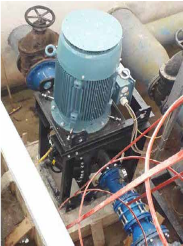
NR. 1 SKDVZ-4P 150-400 75kW
