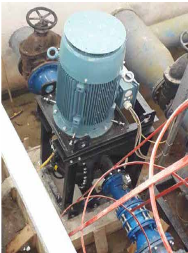
NR. 1 SKDVZ-4P 150-400 75kW
